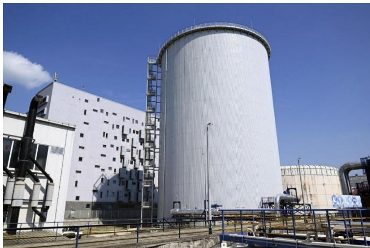
Sl. 6–13 Akumulator topline na lokaciji EL-TE Zagreb
