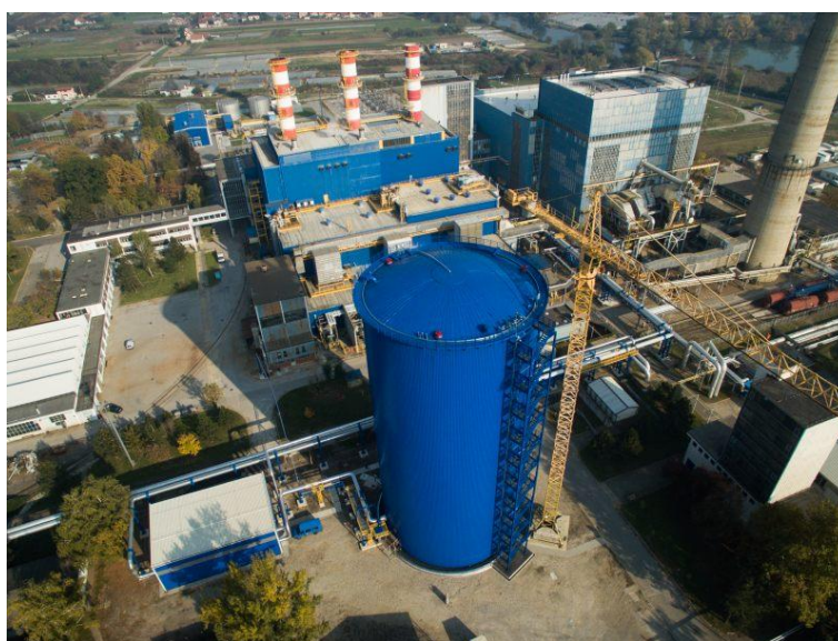
Sl. 6–12 Akumulator topline na lokaciji Pogona TE-TO Zagreb
